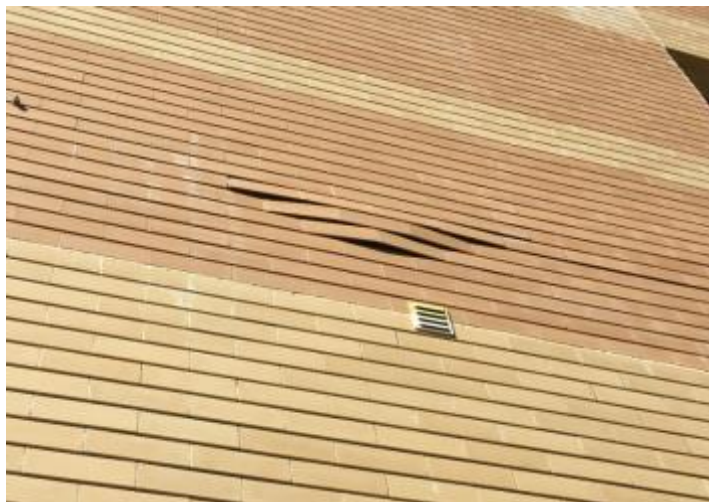
Figura A.8- Empolamento do revestimento cerâmico da fachada.
