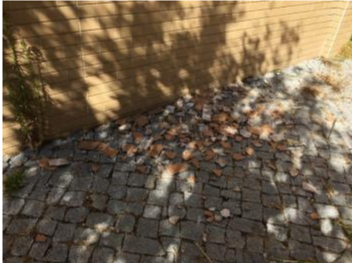
Figura A.7- Vestígios da queda de revestimentos.
