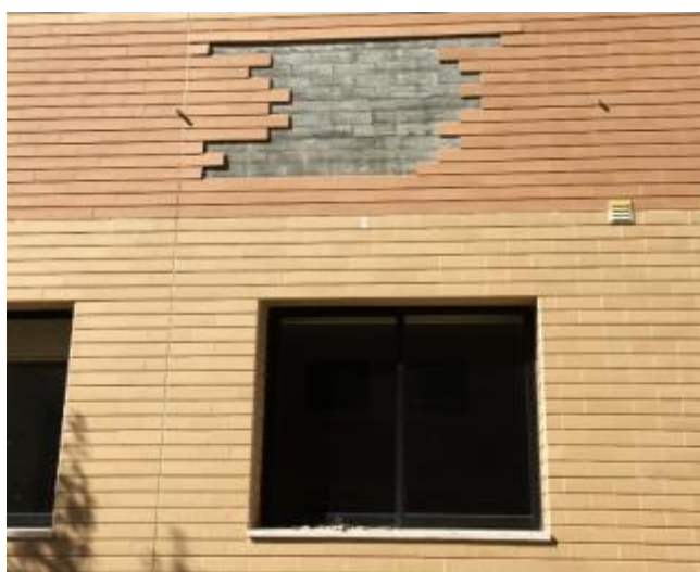
Figura A.6- Perda de aderência e descolamento dos ladrilhos.
